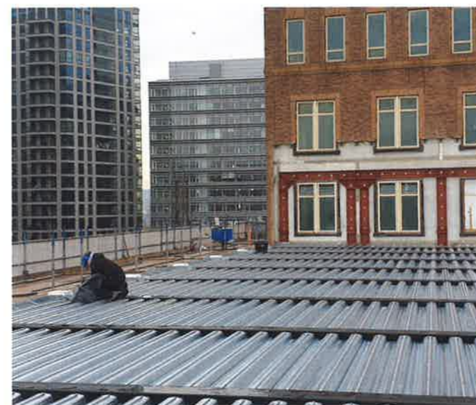
4. Leggen geïntegreerde staalplaten verdiepingvloer. Op de achtergrond is de ingreep op de bestaande gevel zichtbaar.
